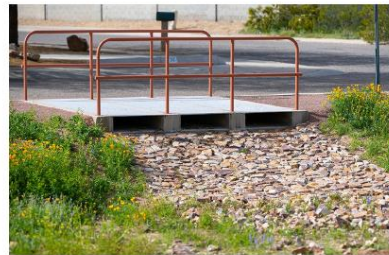
Stormwater Inlet/Outlet Entrada/salida de aguas pluviales
